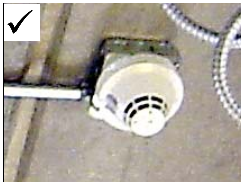
1. ติดอุปกรณ์เข้ากับกล่องพักสายบนเพดานคอนกรีต สายสัญญาณร้อยผ่านท่อที่ต่อกับกล่องพักสาย
